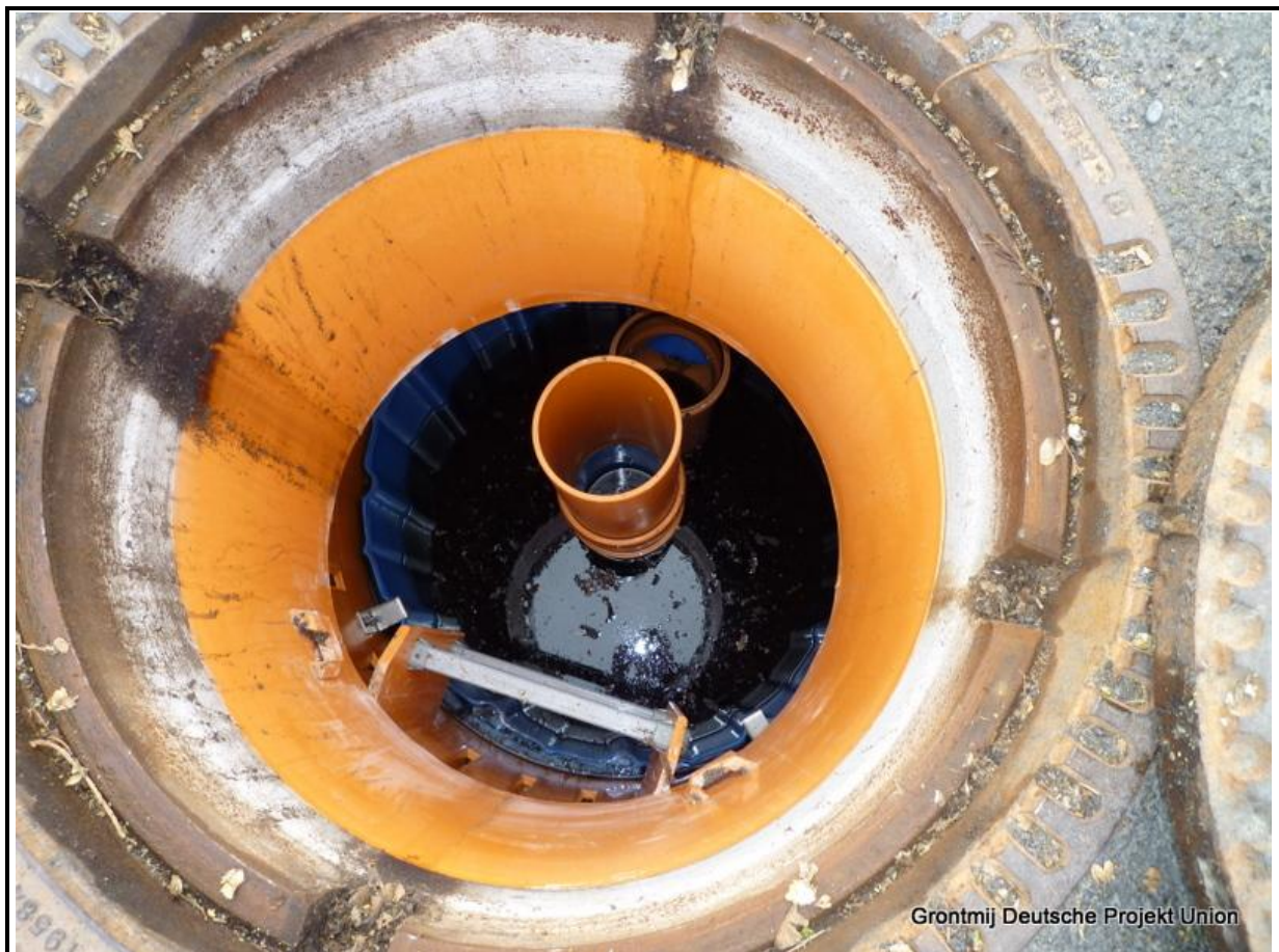
Abb. 8: Blick in den eingebauten Filterschacht
