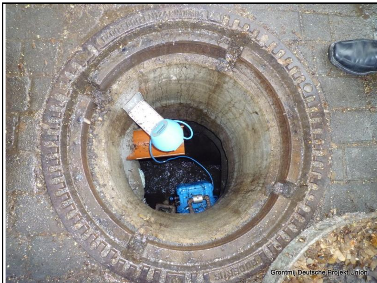
Abb. 7: Notüberlauf im angrenzenden Schacht
