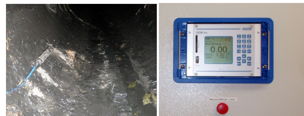
Bild 8 Einbaulage von OCM und Messwertumformer der Zulaufmessung
