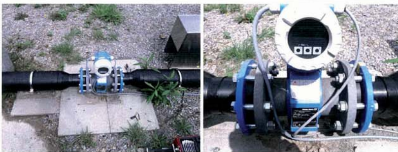
Bild 9 Durchflussmessung Zulauf „heavy traffic“
