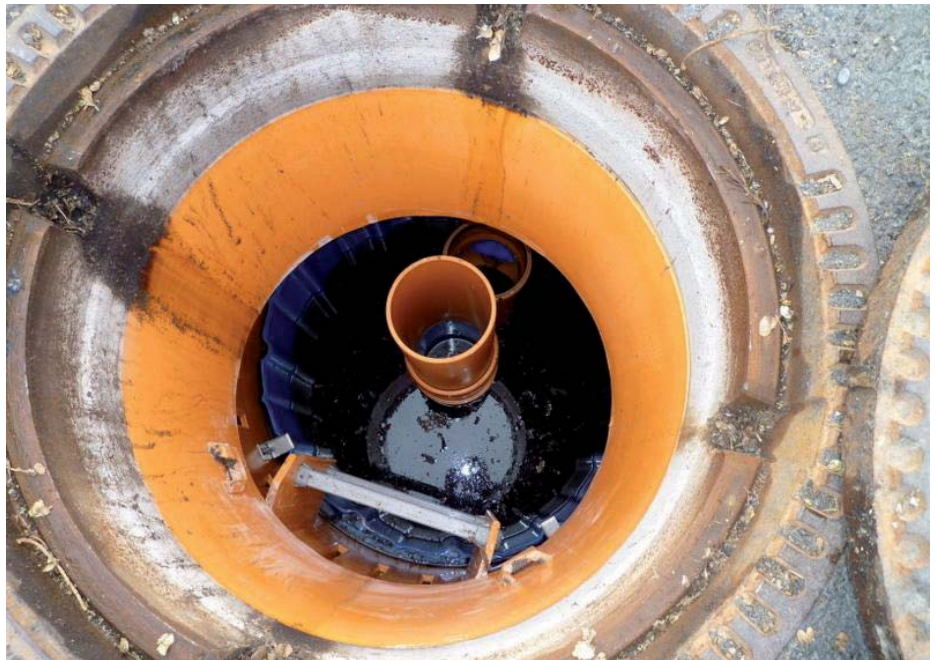
Abb. 3: Blick in den eingebauten Filterschacht
