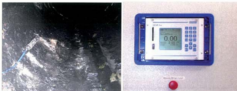
Bild 8 Einbaulage von OCM und Messwertumformer der Zulaufmessung
