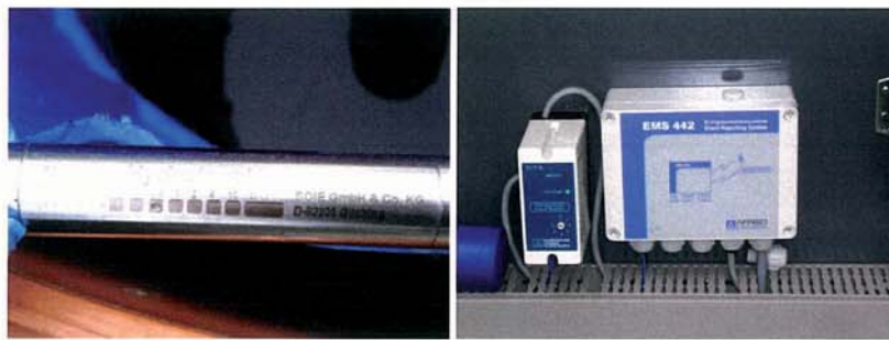
Bild 10 Füllstandsmessung Hydrolevel (links) und Messwertumformer (rechts)
